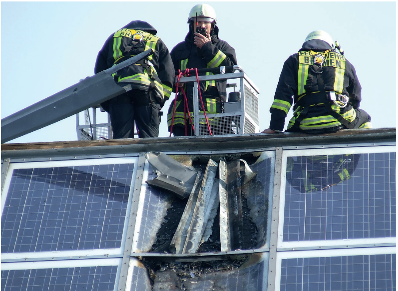
Bild 1 Einsatz der Feuerwehr Bremen an einer PV-Anlage.
